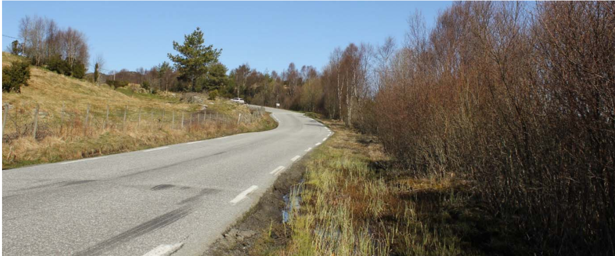
Figur 48 Dagens veg har setningsskader langs Maritjørna, og ein rår til å gjennomføre grunnboringar på strekninga.
