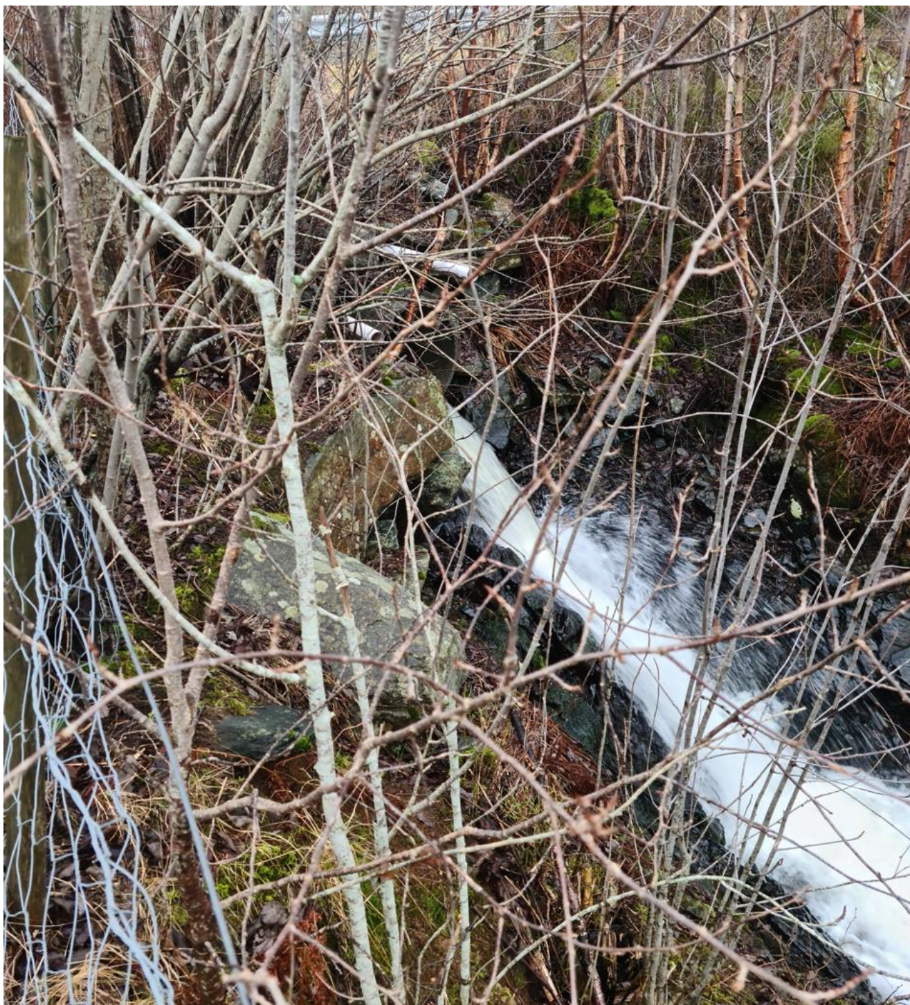
Figur 16 Bilde ved B9 og då utløp etter Sveiogata. Stort fall. Framleis fyllingsgrad ca30%, men høg fart.
