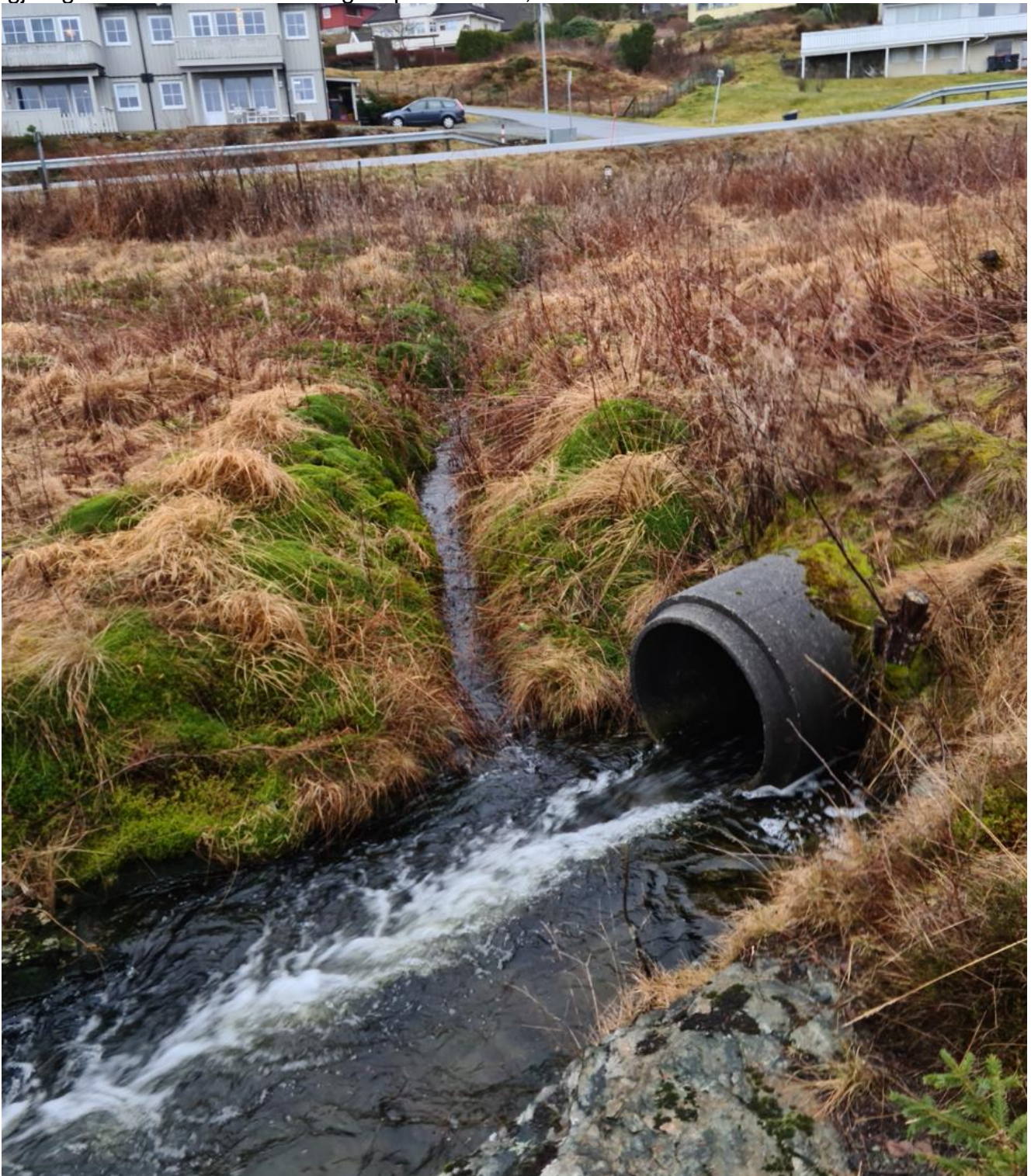
Figur 12 Bilde ved B6. Utløp inne på planområde. Framleis 800mm betong og så ser ein bekk som kjem frå Fjellstadfeltet.
