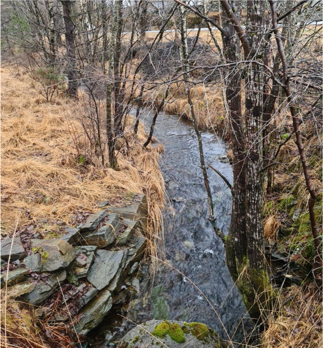
Figur 8 Bilde ved B3 der bekken går inn i 800mm betongrør. Lite fall
