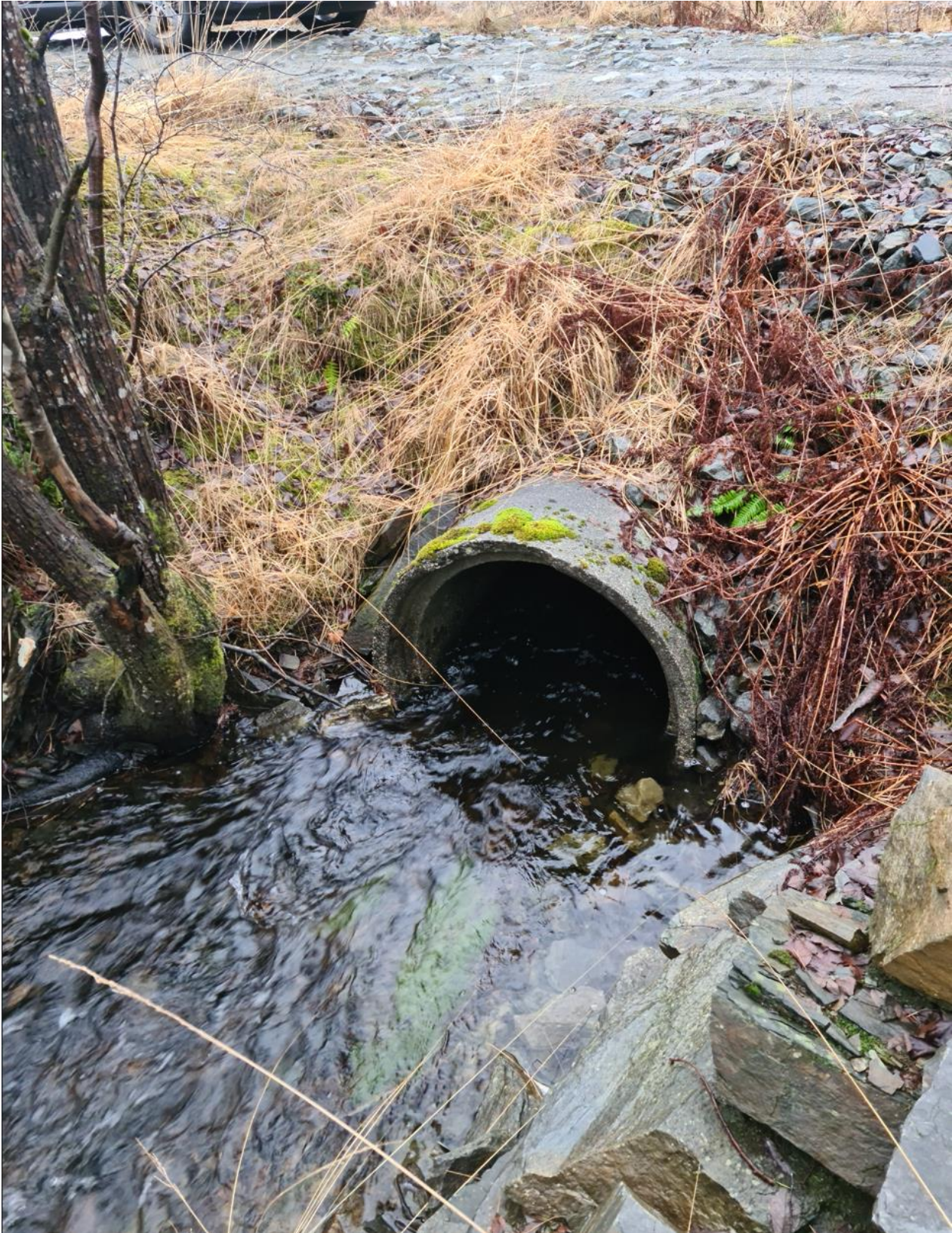
Figur 9 Bilde ved B3 der bekken går inn i 800mm betongrør. Ca 40% fyllingsgrad 26.januar 2022.
