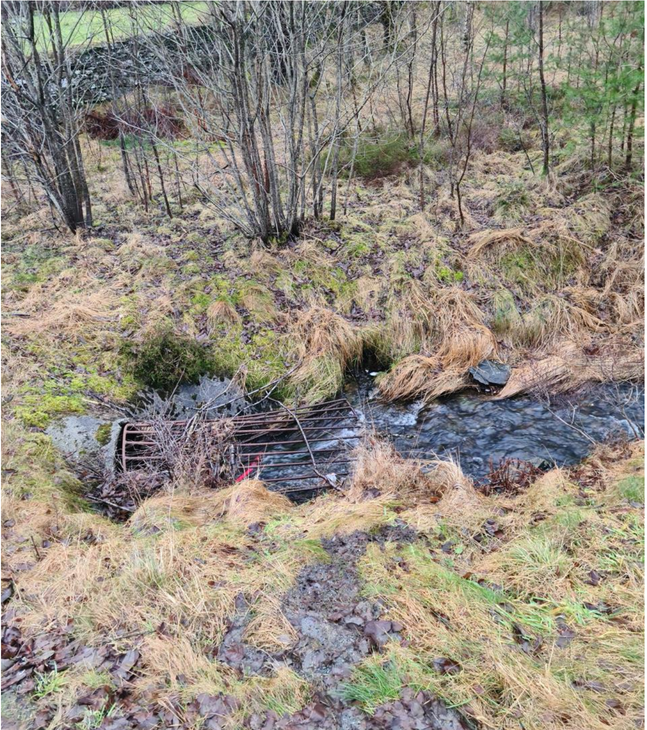
Figur 11 Bekkeinntak med rist under Tjernagelvegen. Denne reinskar kommunen med jamne mellomrom.
