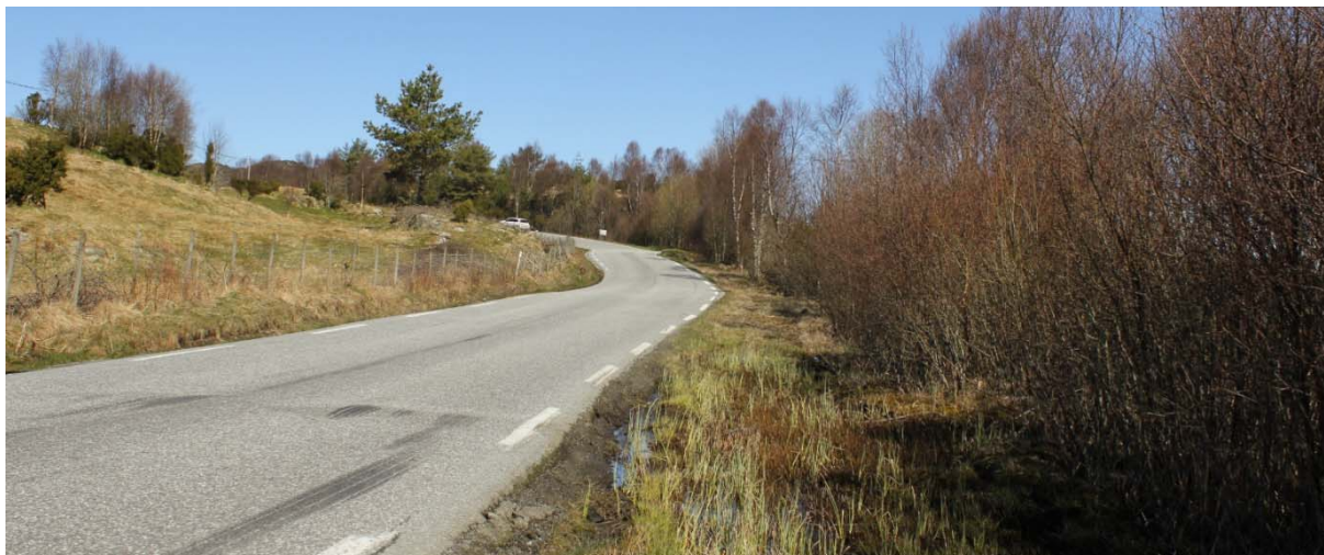
Figur 48 Dagens veg har setningsskader langs Maritjørna, og ein rår til å gjennomføre grunnboringar på strekninga.
