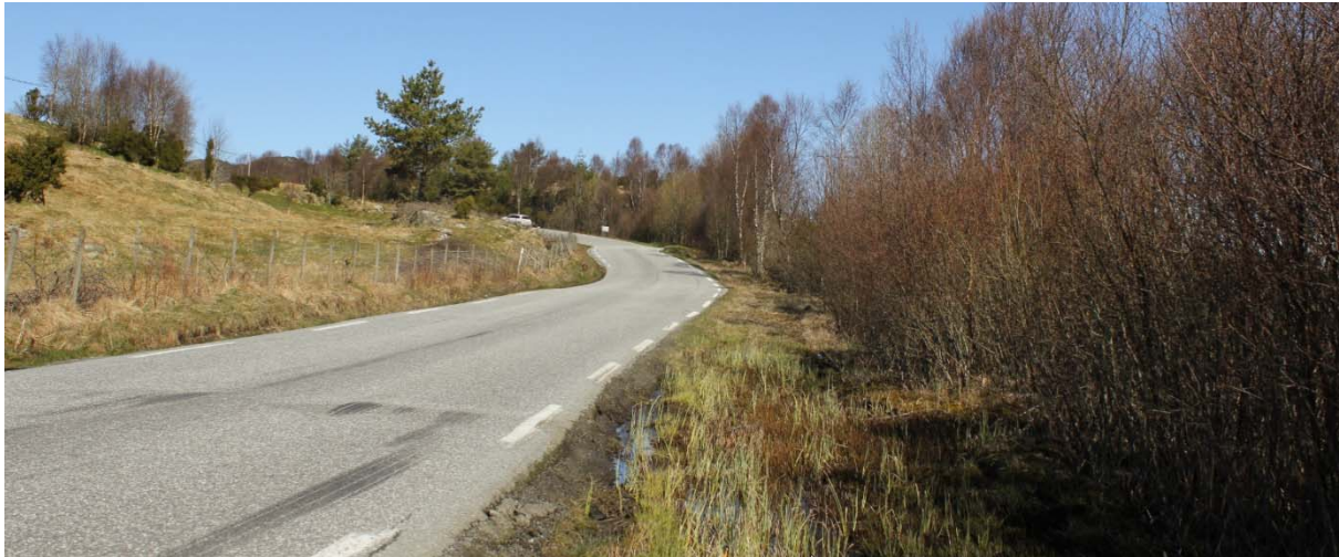
Figur 18 Dagens veg har setningsskader langs Maritjørna, og ein rår til å gjennomføre grunnboringar på strekninga.
